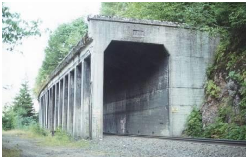
Slika 90. Konstrukcija za zaštitu od odrona – galerija
