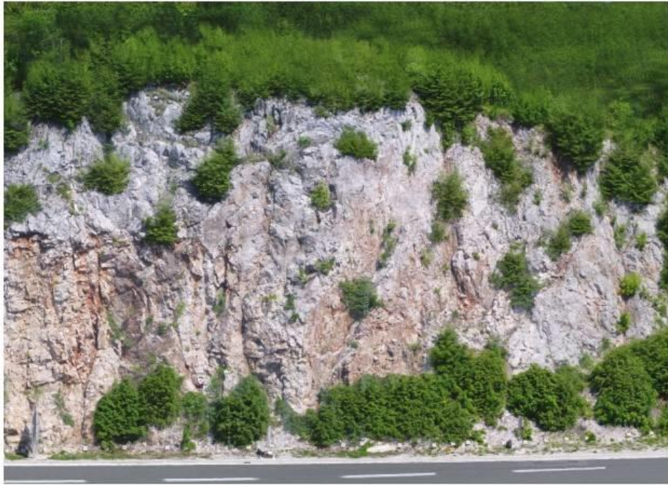
Slika 104. Pogled na stijenski pokos u km 63+500 u smjeru Rijeke
