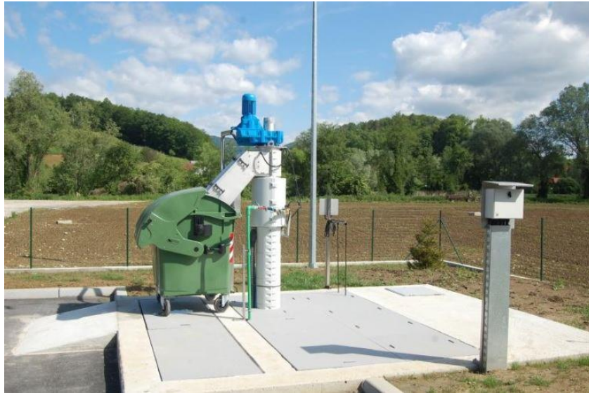
Slika 5: Ulazna crpna stanica
