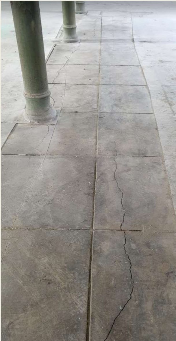
Pukotine u ploči iznad svodova.
