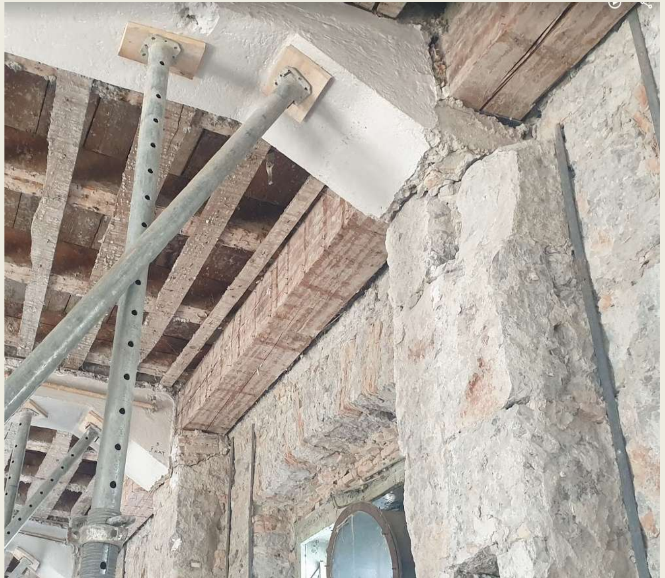
Stanje ležajeva AB greda – vidljive višestruke rekonstrukcije.
