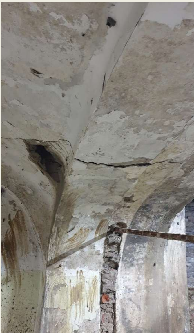
Pukotine u svodovima u suterenu.
