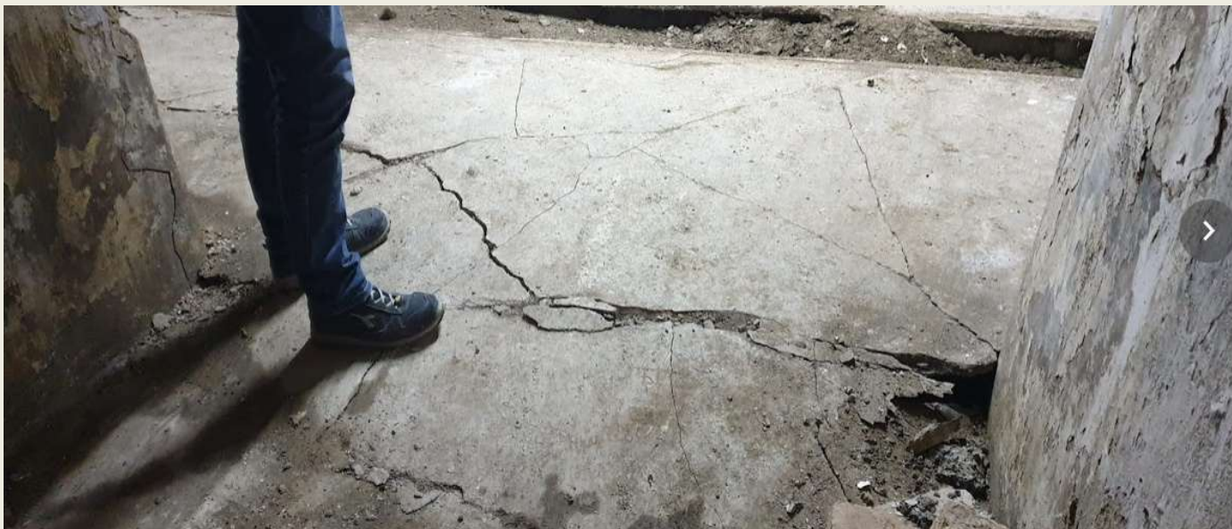
Pukotine u AB ploči u suterenu.
